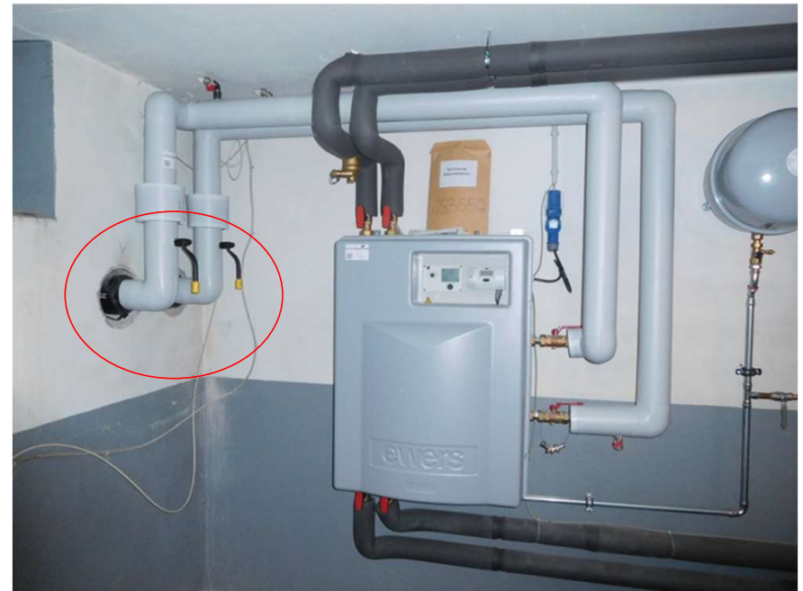
Übergabestation im Haus
